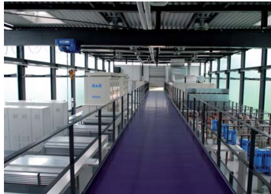
Blick in einen Großbatteriespeicher der Adlershofer Younicos AG. Foto: Younicos
